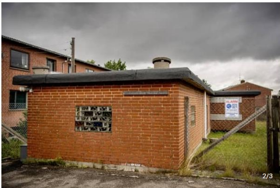
Bækkelund Vandværks maskinhus ligger på Darlingsvej. Her står et vvs-firma for den nødvendige drift, men det er bestyrelsen, der har det overordnede ansvar. Foto: Morten Pape
